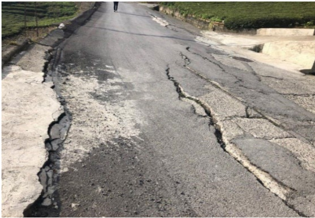
Şekil 4. Dernekpazarı Zincirlitaş mahallesinde oturmaldardan kaynaklı hasarlar.
