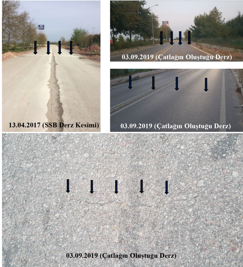
Şekil 6. İlk yansımaya çatlağının oluştuğu yer
