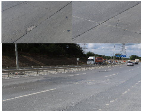
Resim 2. Yüksek Şiddetli Plak Kırılmaları, Derz Kırılmaları, Köşe Çatlakları
