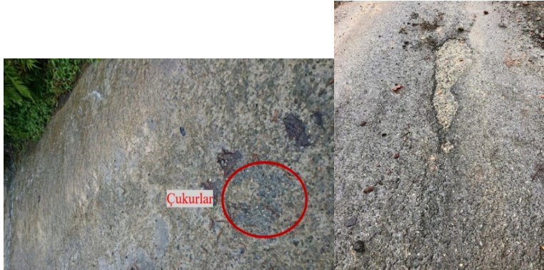
Şekil 6. Çeşitli ilçelerde beton yollar üzerinden akan suyun verdiği hasar. Fotoğrafın ikinci kısmında beton ile asfalt arasına giren suyun oluşturduğu hasar görülmektedir.
