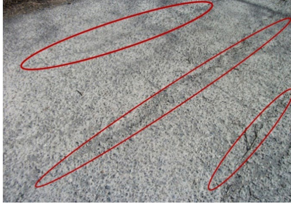
Şekil 1. Trabzon Bulak Mahallesinde beton yollarda boyuna çatlaklar.
