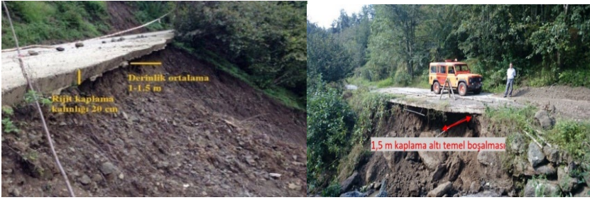
Şekil 5. Trabzon'da çeşitli mevkilerde yağışlar sonrası oluşan beton yollarda alt şev kayması ve beton kaplamanın kısa sürede tamir olana kadar bu kaymalardan oluşabilecek hasarları tolere etmesi
