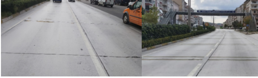
Resim 4. Derz Sökümleri ve Yer Yer Enine Çatlaklar
