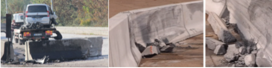
Şekil 6. Beton bariyerlerin çarpma sonrası deformasyonları
