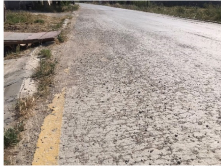
Şekil 3.9. Orta şiddetli harita şeklinde çatlama
