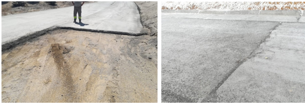
Şekil 2.14. İnşaat derzi parçalanması
