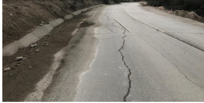
Şekil 5.1 Etkin çalışmayan drenaj yapısı deformasyon oluşumu
