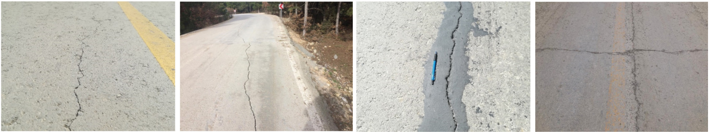
Şekil 2.8. Doğrusal çatlak oluşumu
